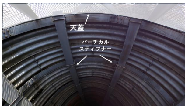
Fig. 6 井浅部のバーチカルスティフナー (集水井 3)
