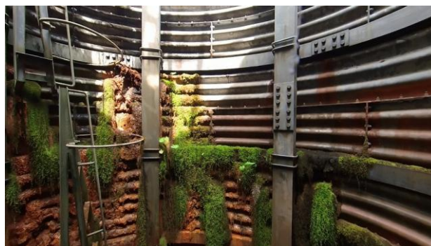
Fig. 8 補強リングに付着する植物 (集水井 3)
