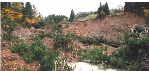
写真 2 地すべりブロック内の状況
