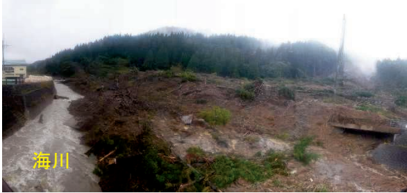
写真-6 堆積域の状況 (2017. 10. 29 撮影)
