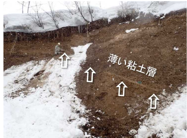
写真-5 滑落崖における斜面内部の地質状況 2 (平成 29 年 3 月 17 日撮影(古谷ほか, 2017))
