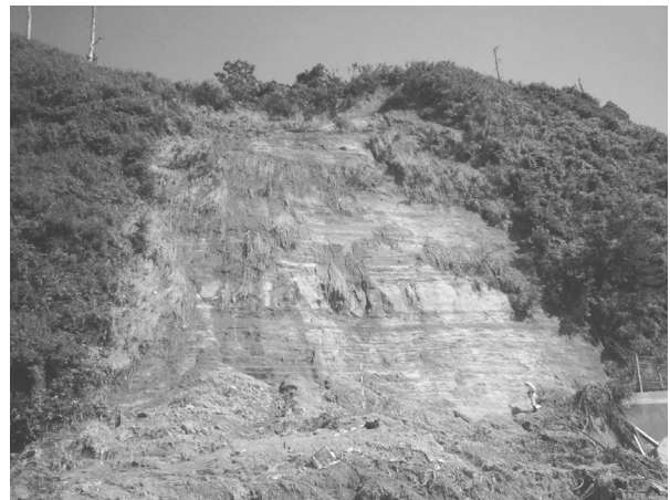
写真-1 7.13豪雨による崩壊の1例。地肌のむき出した急崖は崩壊の発生場所ではない。露岩した部分は斜面上端部で発生した崩壊土砂が表土をはぎ取りながら流れ下った跡であり,地山自体は安定している(2004年7月22日撮影)。
