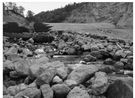
写真－10 流路下流の侵食状況(2010)
