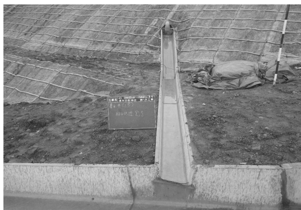
図-7 集水井からの排水を用水として活用
