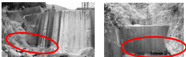
【写真-1 谷止工・床固工・護岸工の洗掘状況】
