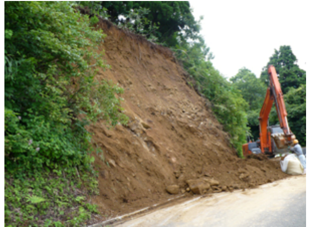
写真-4 柏崎市小村峠地区。小村峠、稜線付近にある切り土のり面の崩壊
