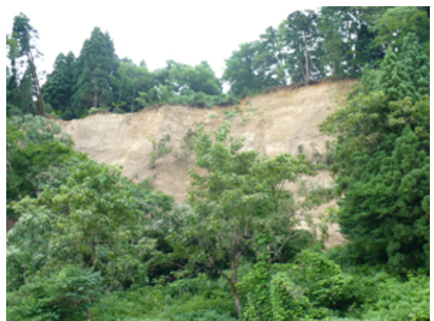
写真-8 柏崎市大沢地区。大沢峠に至る道路脇の急斜面の表層崩壊
