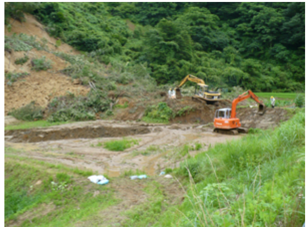
写真-12 写真-11の崩壊土砂が堆積した農地（水田）
