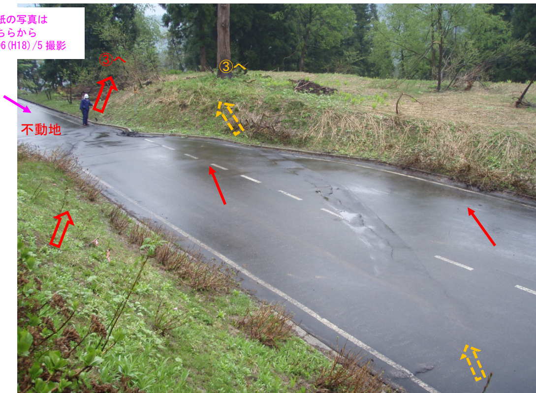
④中部ブロック北側側部を通る道路に発生した亀裂：2012（H24）/5/18 写真③の主・副亀裂に連続する
