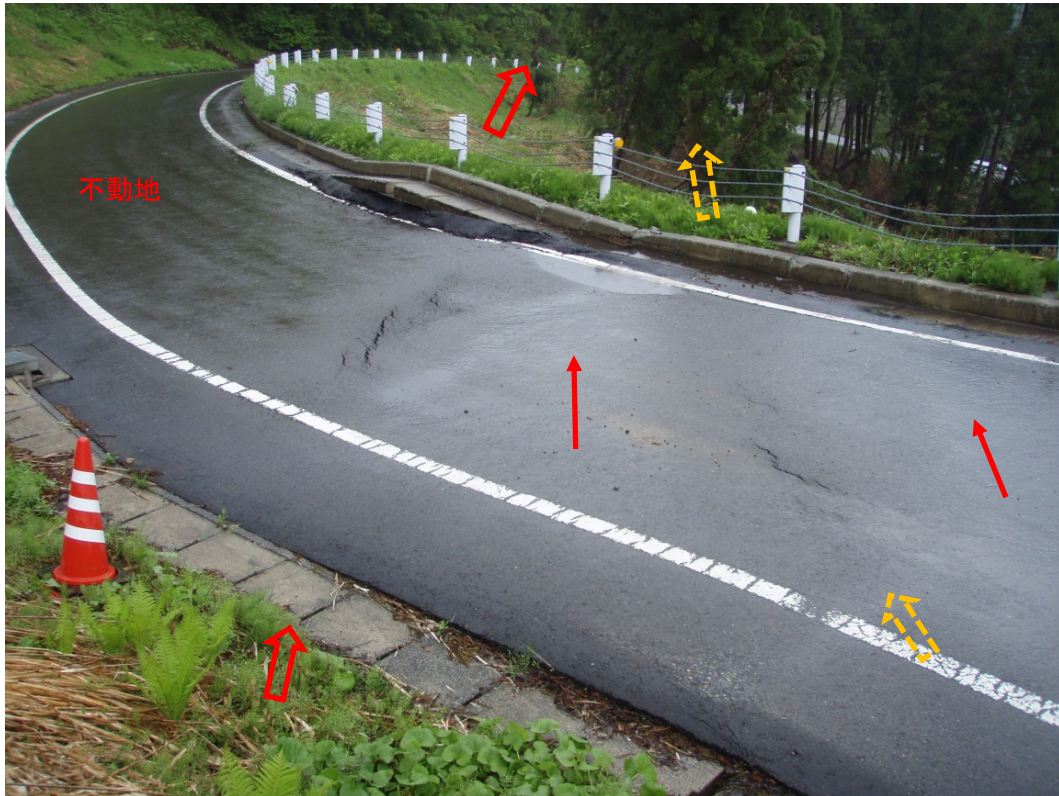
③中部ブロック北側側部を通る県道に発生した亀裂：2012（H24）/5/18 主亀裂（赤実線↑）の地すべりブロック側に2～5m程度離れて副亀裂（黄破線↑）が見られる
