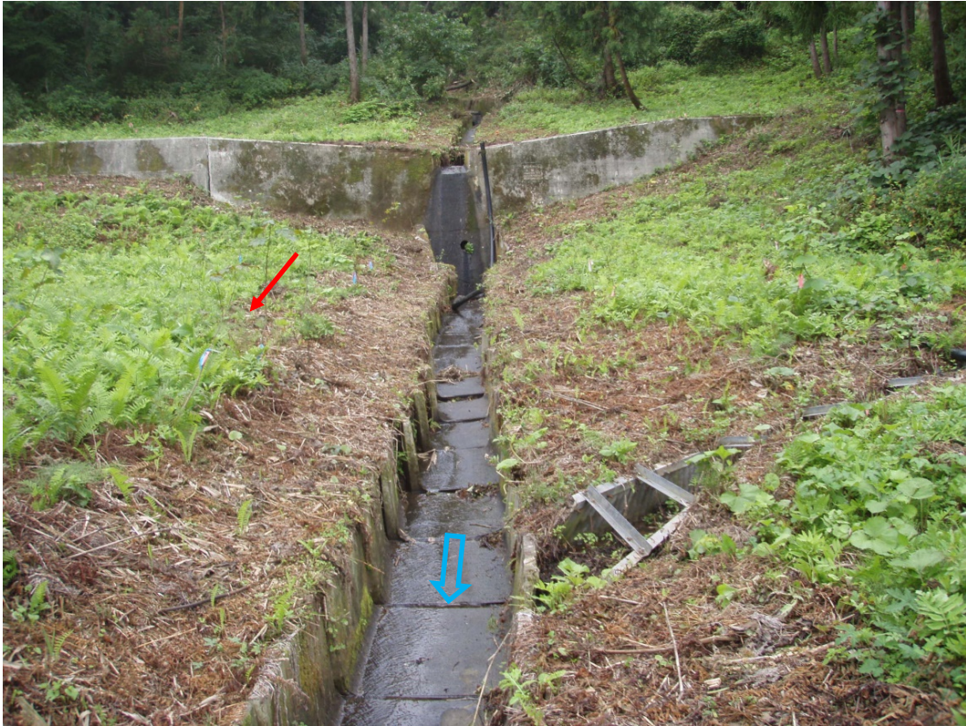
①平成 5～7 年に施工された下部ブロック末端水路工の変状：2012 (H24) /9/28
