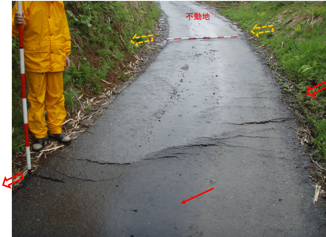
⑨中部拡大ブロック南側側部を通る県道に発生した主亀裂と副亀裂：2012/5/25 南側の亀裂はブロック側が主亀裂として明瞭で北側の亀裂状況と逆である
