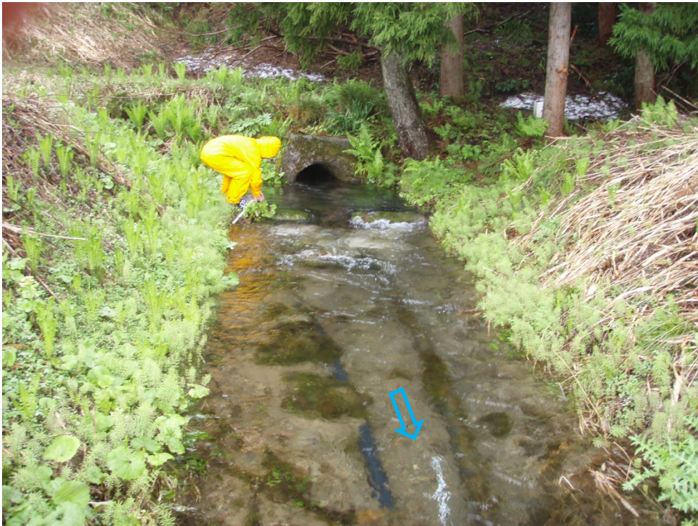
⑤中部ブロック頭部排水トンネル排水状況：2012（H24）/5/26 土水路のため、中部ブロック内への浸透が多かった
