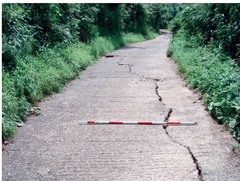
写真-9 Bブロック末端の市道に発生した亀裂の状況
