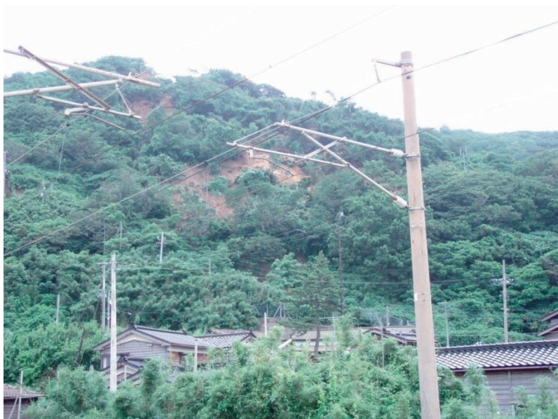
写真-7 地すべり発生直後の斜面の状況 樹木は元々の位置から移動していない
