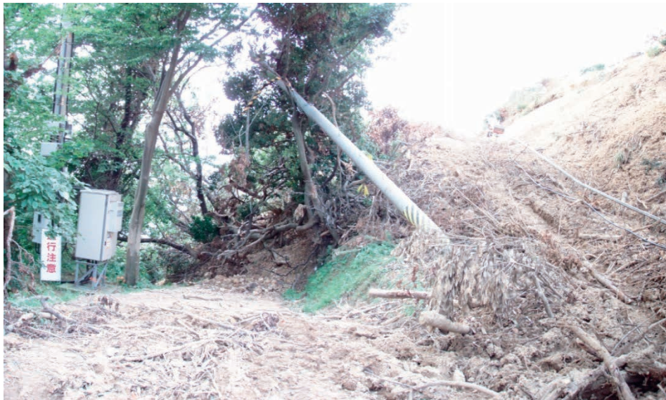
写真-5 市道上に堆積した土砂の状況 市道の変位は見られない
