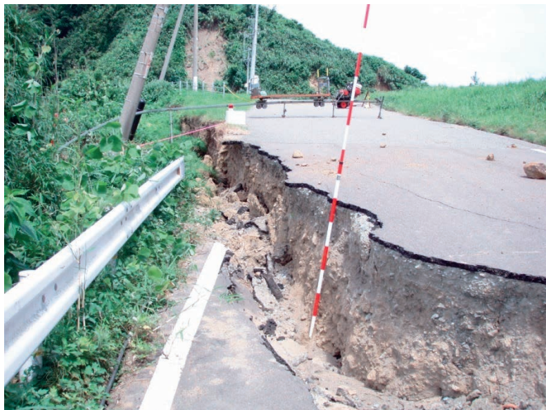
写真-8 Bブロック頭部の段差の状況
