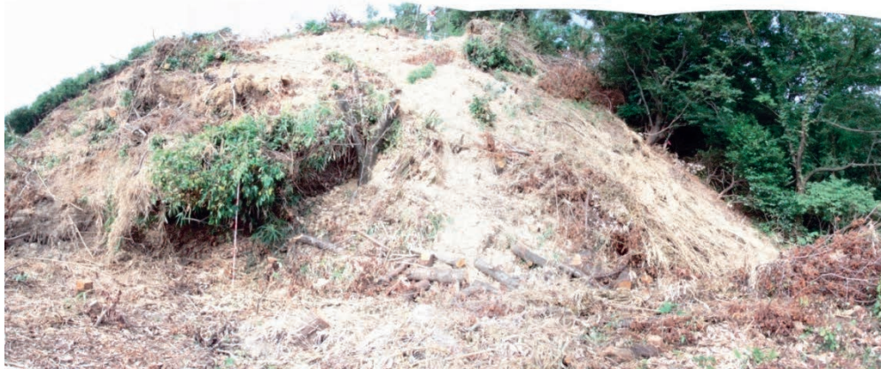
写真－3 Aブロック中段の緩斜面上に押出して止まっている移動土塊の状況
