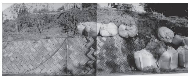
写 3-4, 県道脇擁壁より簡易土留め落下 (撮影 : 11月7日)
