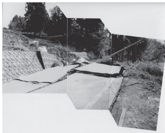
写 3-6, 県道の被害状況（5mの移動） (撮影：11月8日)
