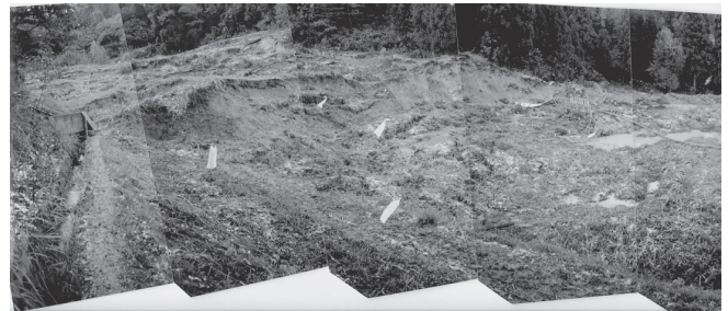
写 3-7, C1-2 滑落崖 (落差 5~10m) (撮影: 11月9日)
