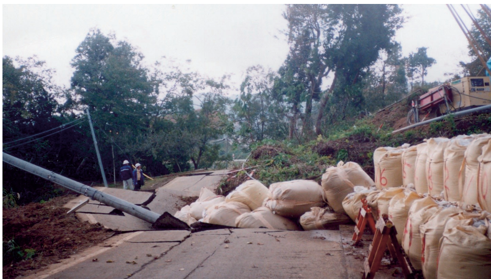
県道約 5m 程度下方へ移動 <撮影:平成 14 年 11 月 8 日>
