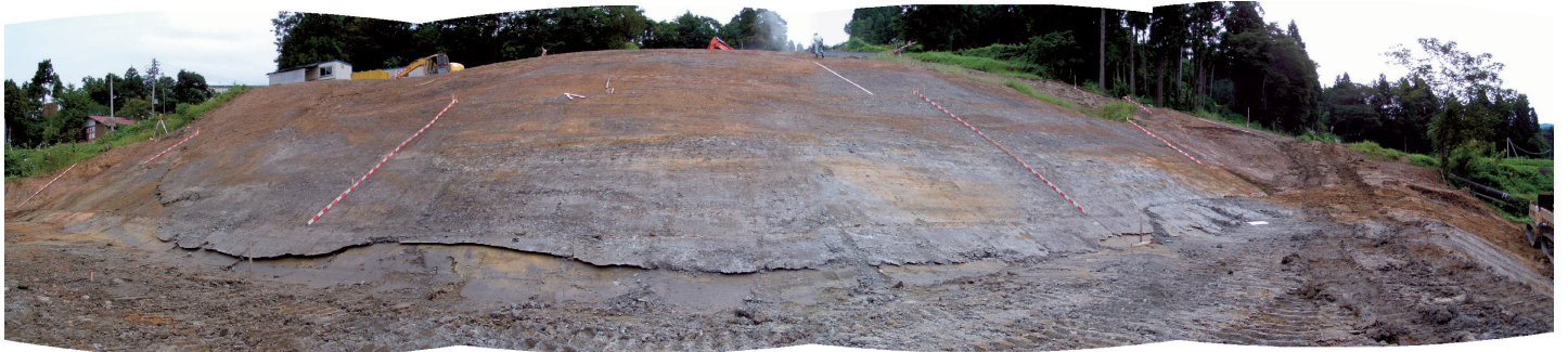
施工時、河川脇に露出したC1-3ブロックすべり面 <撮影:平成15年9月>
