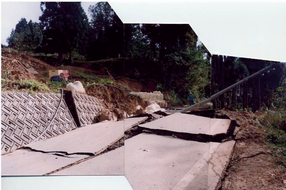
C1-3 の活動により道路に被害が発生 <撮影:平成 14 年 11 月 8 日>
