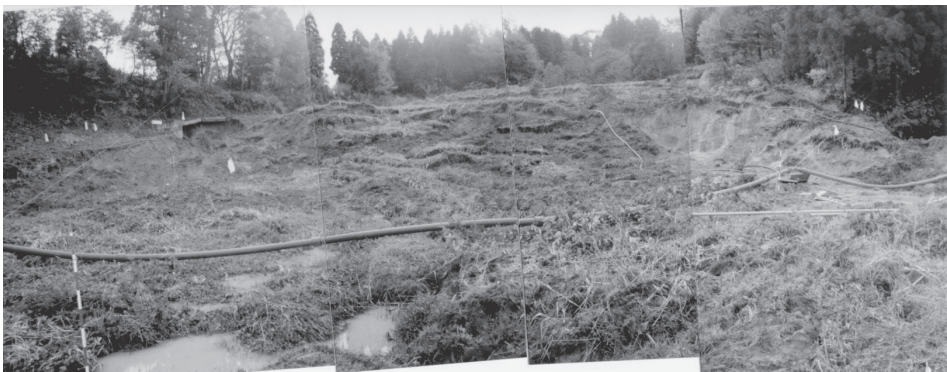
写3-13, C1-2ブロック滑落崖を村道より望む。落差最大10m程度。 (撮影：11月16日)
