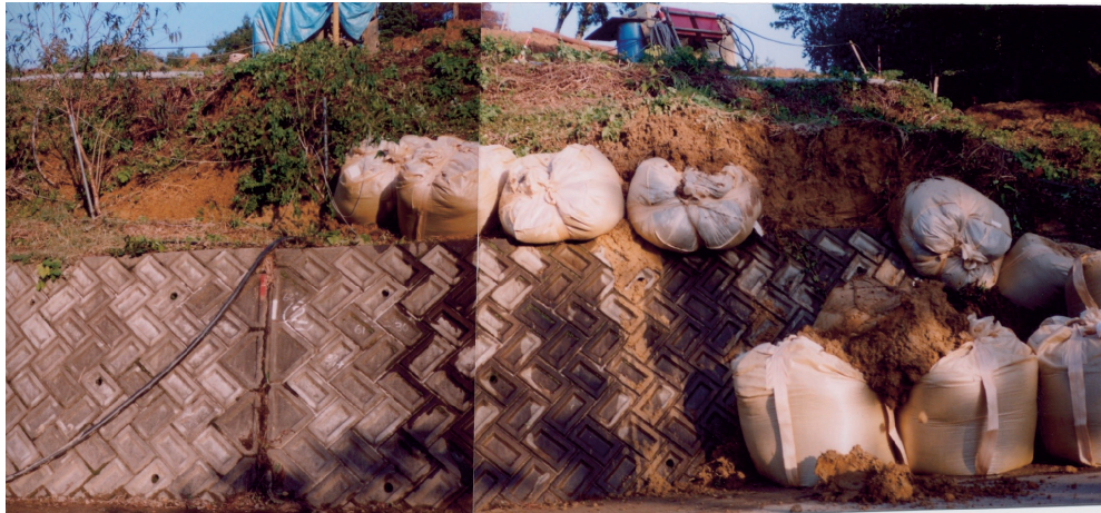
地すべり末端下方へ移動し、擁壁より落下 <撮影:平成 14 年 11 月 7 日>
