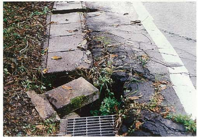
同県道沿いのU字溝の変状 (H14年 9 月)
