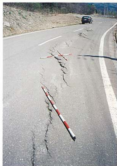
県道の被災状況（H10年 5 月） 毎年春先に約300mにわたり移動方向に 斜交する「ミ」型雁行状亀裂群が発生
