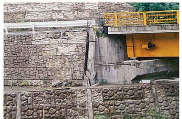
大所地すべり末端部にあたるきじやがわ橋の護岸擁壁の変状 (H14年 9 月)
