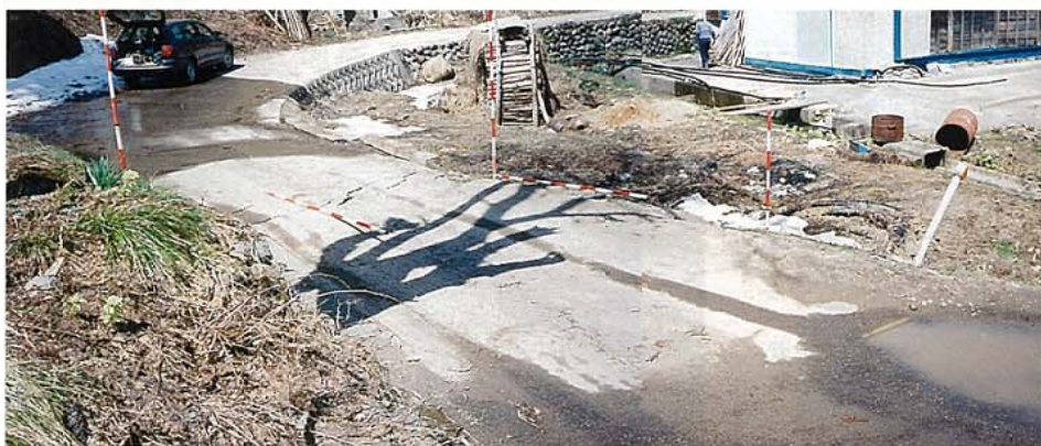
木地屋集落南側の県道に発生したクラック（H10年 5 月） 地すべり左翼境界部にあたり毎年融雪期にせん断亀裂が形成 右は拡大写真
