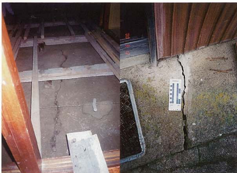
大所集落民家床下に発生したクラック (H14年 9 月)
