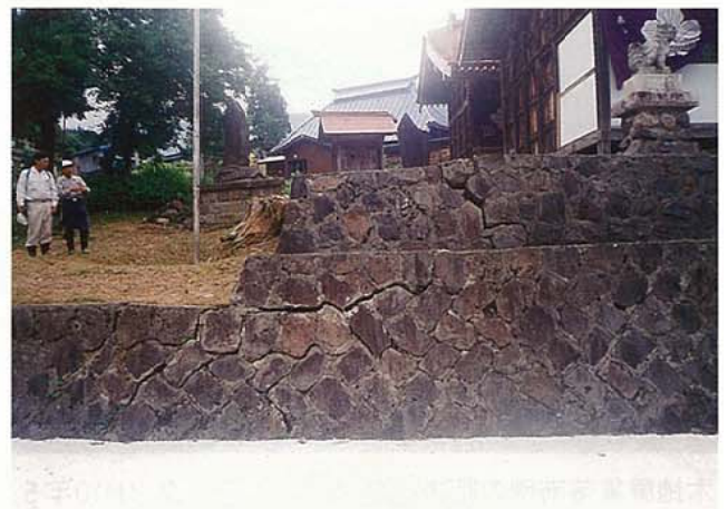
同神社の石積みに発生したクラック (H14年 9 月)
