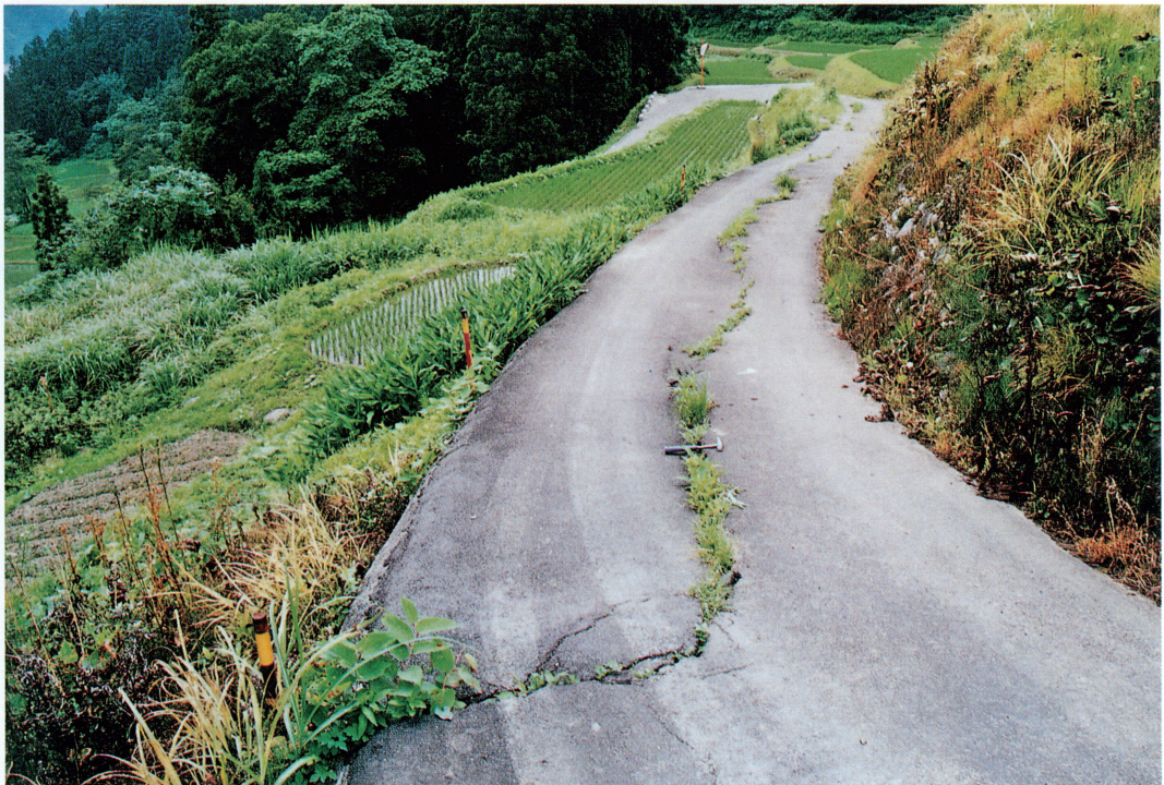
写真一 4 Bブロック下部の「田沢地区」との境界付近の農道に発生する亀裂、毎年微量ではあるが沈下して亀裂が拡大するため、その都度補修を行う
