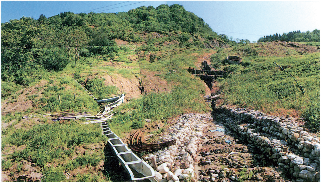
1980年5月27日、上流部斜面の活動は激しく、施工された工事はたちまちのうちにこのような状態になってしまう。
