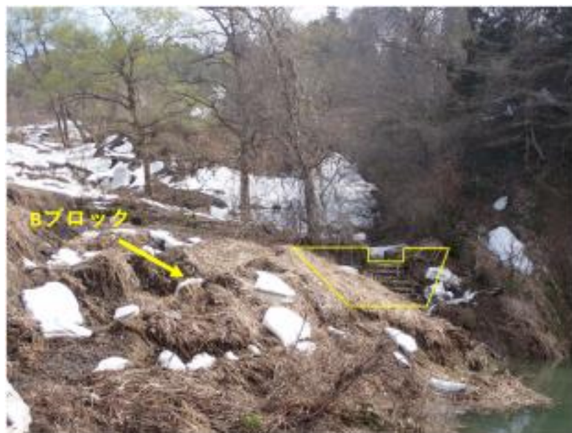
写真 2. 18 床固工被災状況
