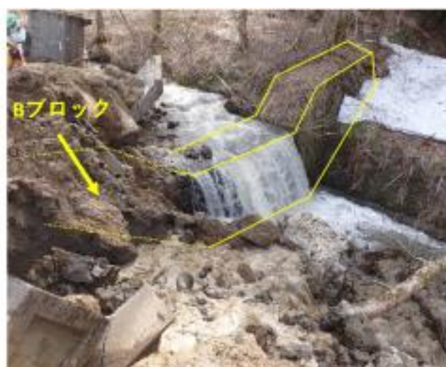
写真 2. 22 砂防堰堤被災状況
