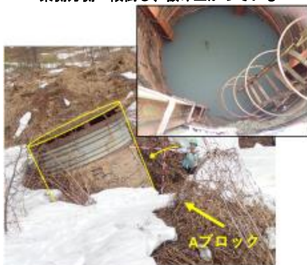
写真 2. 14 集水井工 03(上 20)被災状況 斜面下方へ傾倒している 井筒内は湛水している
