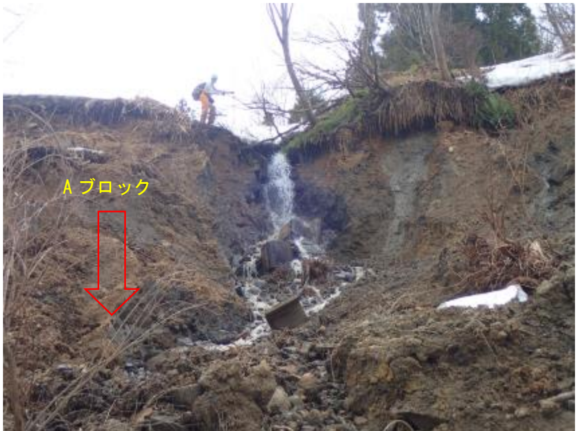
写真 2. 28 滑落崖より流入する地表水(既設水路工が破損) (R5. 4. 6 撮影)
