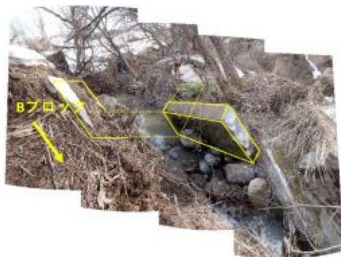
写真 2. 20 砂防堰堤被災状況
