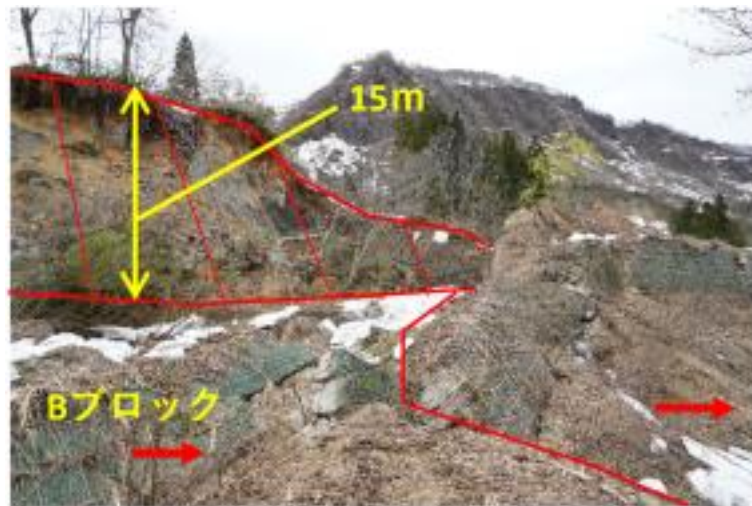
写真 2. 4 B ブロック西側方部状況 尾根を分断する線状凹地が認められる 側方崖：比高最大 15m
