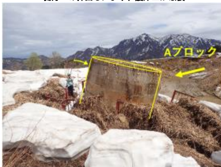
写真 2. 13 集水井工 02(上 17)被災状況 東側方側へ傾倒し、抜け上がっている
