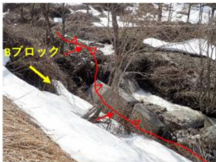
写真 2. 12 Bブロック末端部西側方部状況 側方への押出しにより、護岸工が破損
