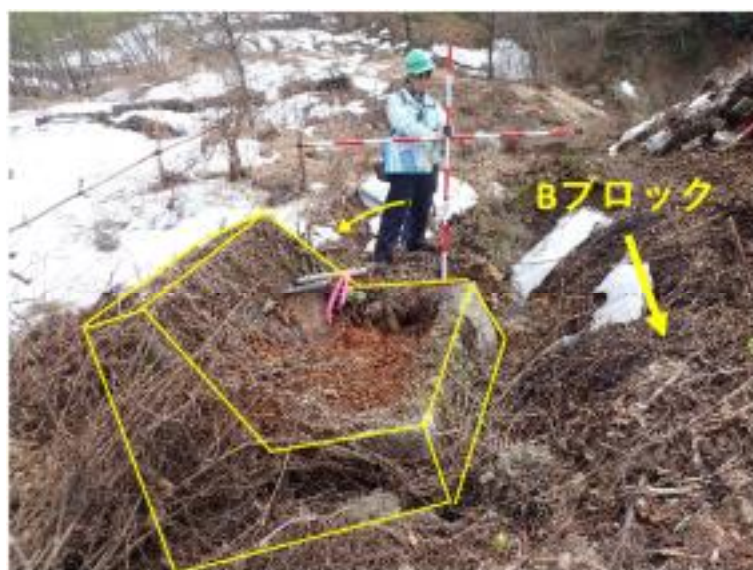
写真 2. 17 横孔 Bo 工被災状況
