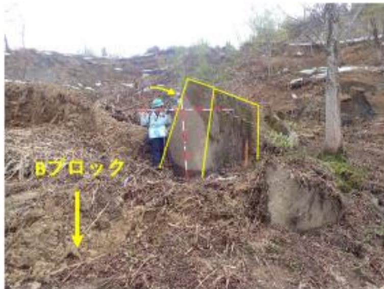
写真 2. 15 横孔 Bo 工被災状況 保護壁が前面へ傾倒している
