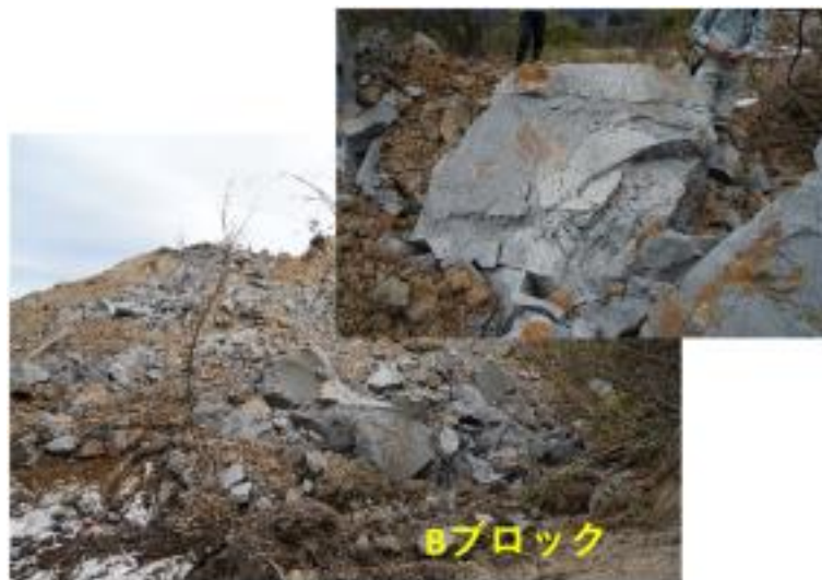
写真 2. 10 Bブロック西側方部 露岩状況 線状凹地内部には弱風化泥岩が認められる 弱風化岩盤に達する地すべりが想定される
