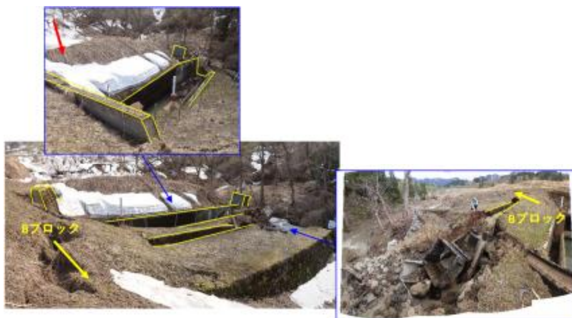
写真 2. 26 農業用水取水施設被災状況
