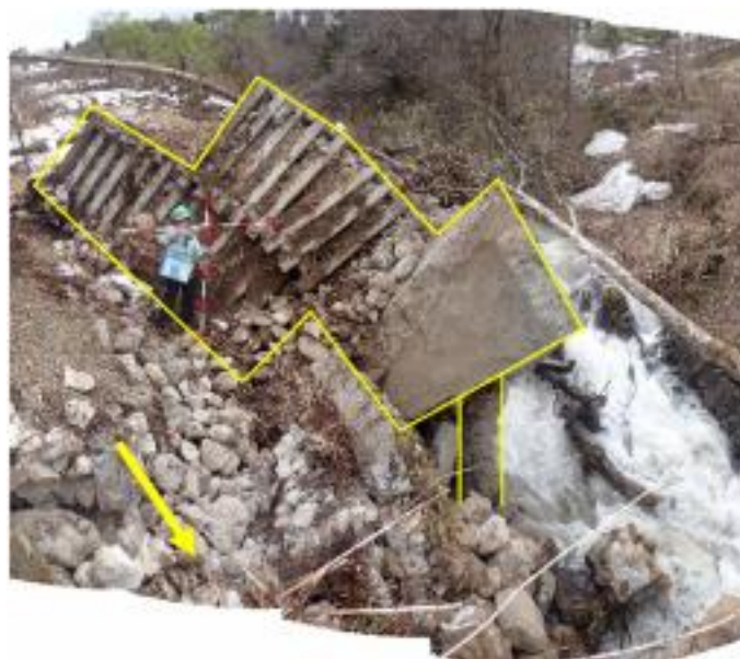
写真 2. 19 護岸工被災状況
