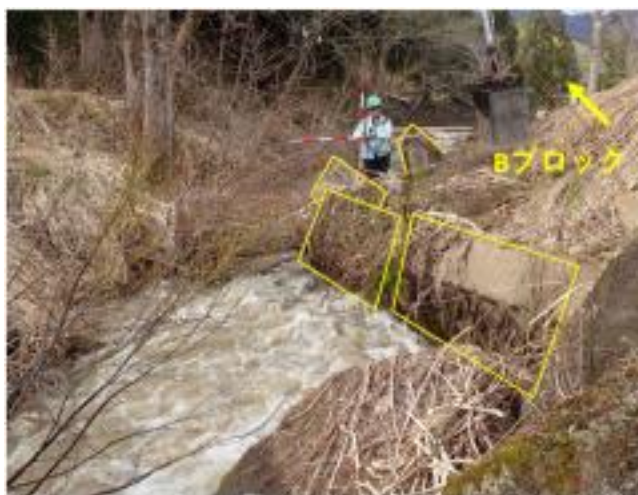
写真 2. 21 護岸工被災状況
