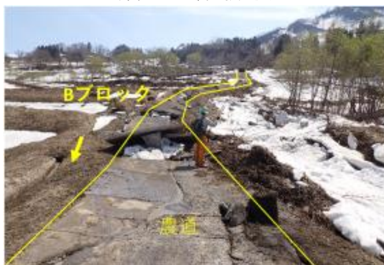
写真 2. 25 農道被災状況
