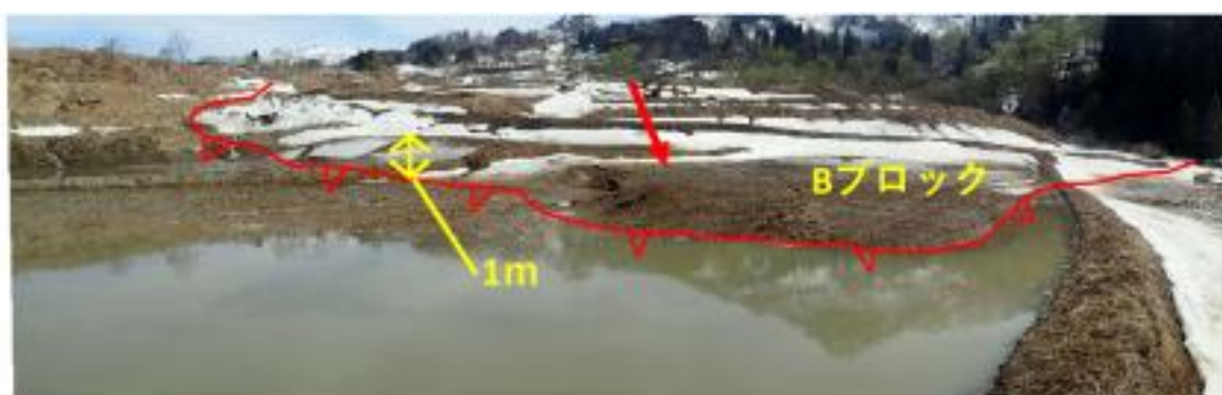
写真2. 8 Bブロック末端部状況 押し変状が認められる。押し出し部：隆起量最大1m
