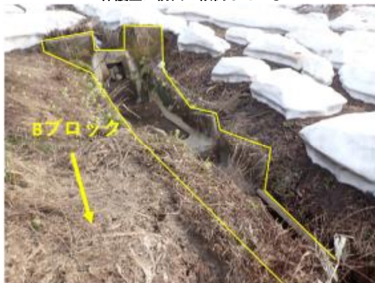
写真 2. 16 水路工被災状況
