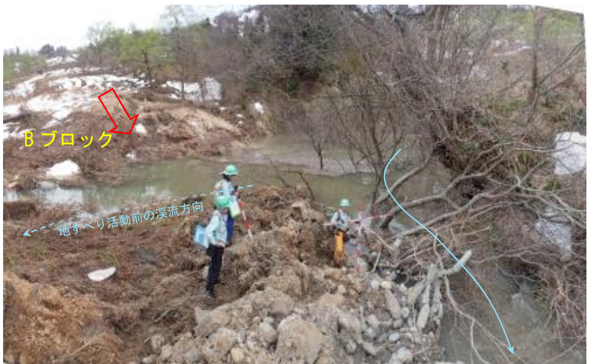
写真 2. 29 地すべり活動により形成された大滝川の湛水池 (R5. 4. 6 撮影) 移動土塊が溪流を閉塞し、側方リッジの外側を越流する
