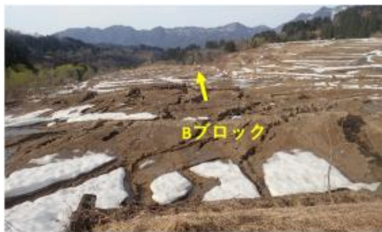
写真 2. 24 農地被災状況
