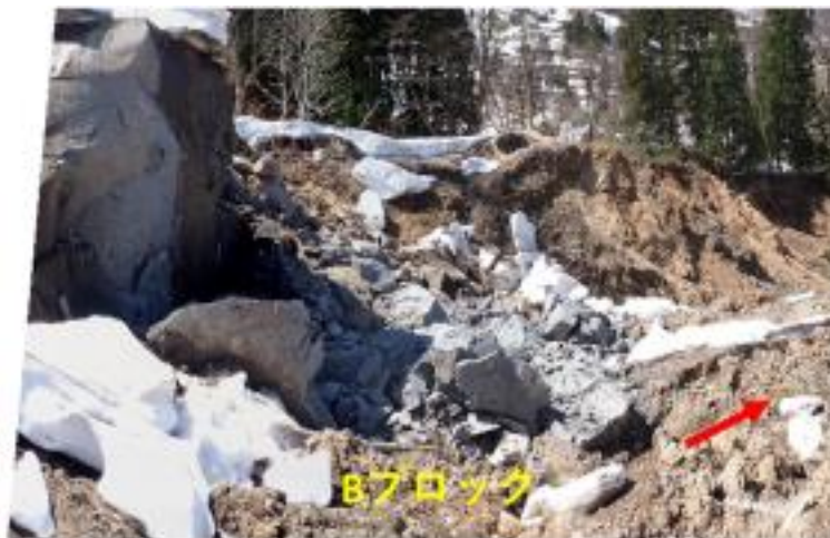
写真 2. 5 B ブロック西側方部 露岩状況 尾根を分断する線状凹地内部には、基岩を形成していた弱風化泥岩の岩塊が多数分布することから、岩盤に達する新たなすべり面が形成されたと想定される
